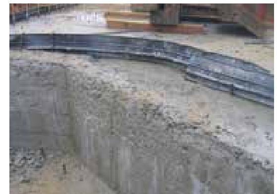
Zdjęcie 1. Uszkodzenie ściany fundamentowej wskutek przemrożenia świeżego betonu
