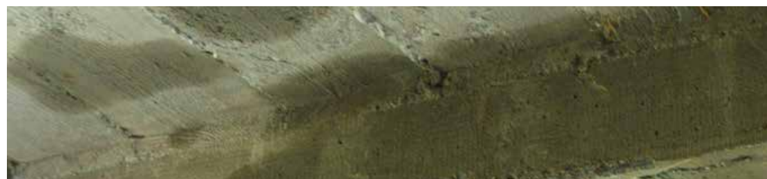
Zdjęcie 3. Uszkodzenie płyty stropowej wskutek przemarzenia świeżego betonu
