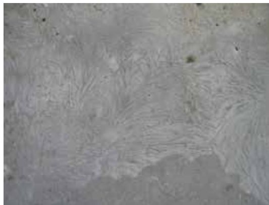
Zdjęcie 2. Zarysowania wywołane przemarzeniem na powierzchni świeżego betonu
